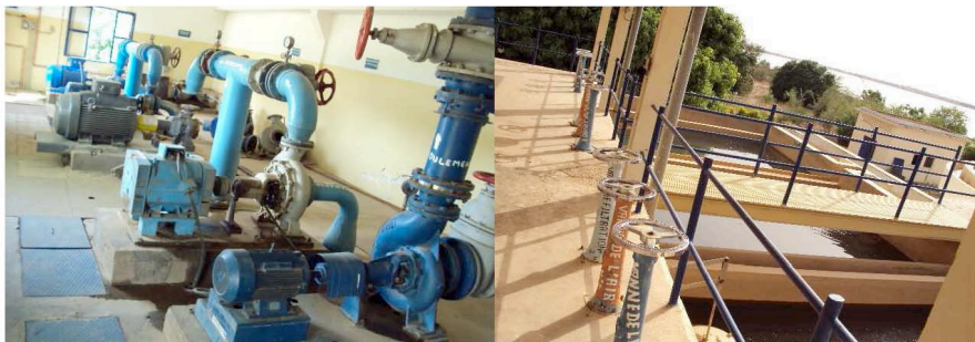
Figure 8: Station de pompage et de traitement de la SOMAGEP-SA au bord du fleuve Niger
